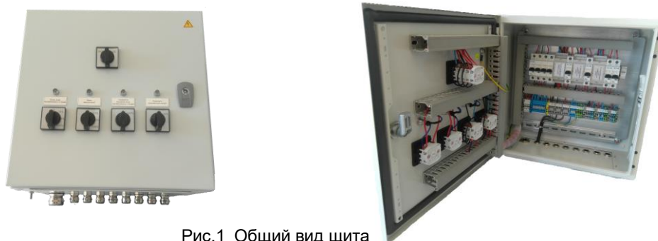
Рис.1 Общий вид щита
